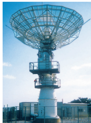
沖縄第1可搬局用パラボラアンテナ
